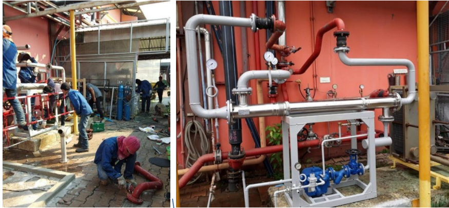
ภาพที่ 12 ทำการติดตั้งที่โรงงานและใช้งานจริง
