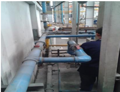
รูปที่ 12 ท่อที่ใช้จุดต่อเป็นยูเนียนก่อนการปรับปรุง (สุมาลี อุไร, 2560)
