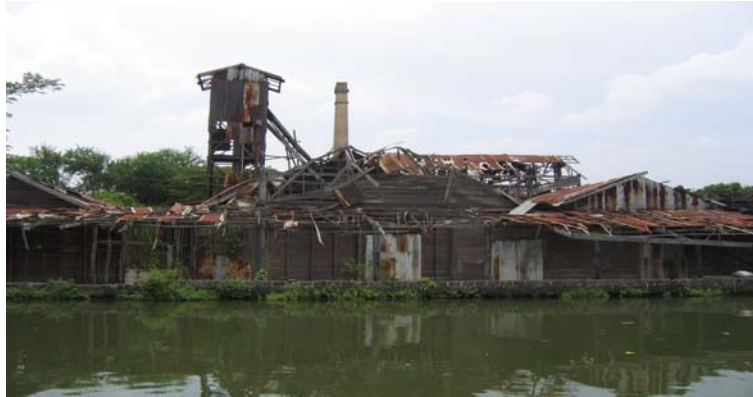
โรงไฟฟ้าหนองแขม ภาพถ่ายโดย นายอนุพงษ์ อินฟ้าแสง เมื่อวันที่ 11 เมษายน 2549
